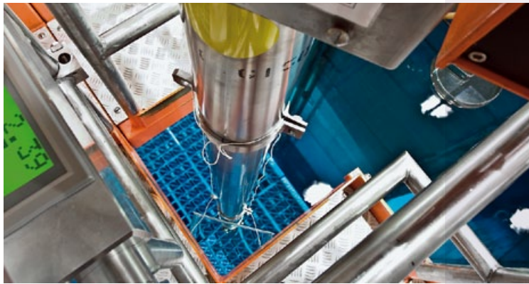
△ Das Brennstoff-Kompaktlager im Containment wird nur während der Revision benutzt. Es bietet Platz für die Auslagerung des kompletten Kerninhaltes.
