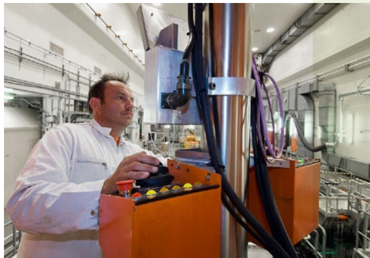
△ Ein Mitarbeiter bewegt mit der Brennelement-Handhabungsmaschine die sich im Wasser befindenden Brennelemente im Abklingbecken.
