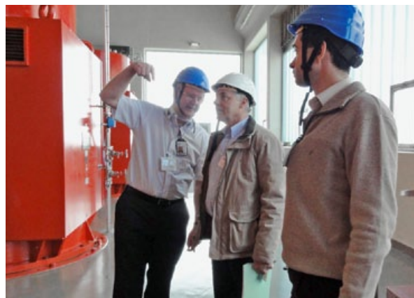
△ Der tägliche Augenschein vor Ort, hier im Hauptkühlwasser-Pumpenhaus, ist die Grundlage der Untersuchungen während eines WANO Peer Review.
