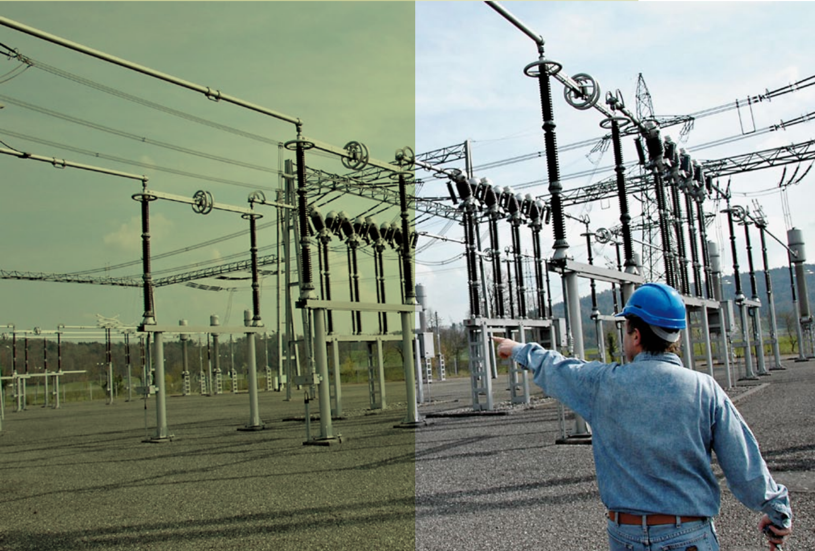
△ Via diese Freiluftschaltanlage speist das KKL den Strom ins schweizerische Hochspannungsnetz ein. Dies geschieht über zwei Leitungen, die eine führt zur Verteilanlage Beznau, die andere zur Verteilanlage Laufenburg.
