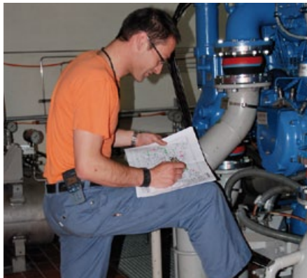
△ Unsere Sicherheitskultur wird getragen durch die entsprechende Einstellung und das richtige Verhalten jedes Einzelnen – Tag für Tag. Regelmässige Rundgänge, hier bei einem Notstromdiesel, tragen zur Sicherheit bei.
