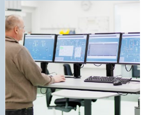
△ Einfache Bedienung per Mausclick: Prozessbedienstation der Vollentsalzungsanlage.
