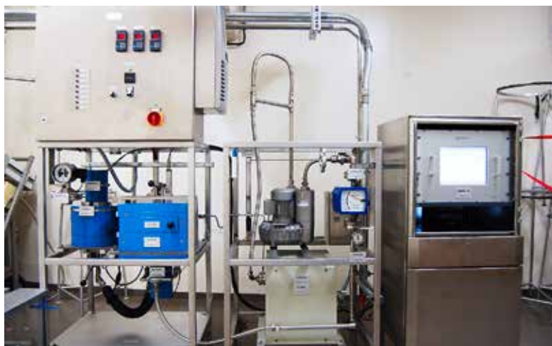
Das CAC-System dient der ständigen Überprüfung der Raumluft innerhalb des Reaktorgebäudes.
