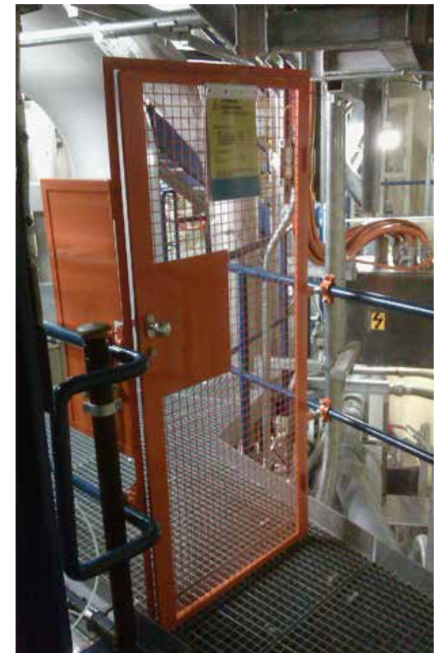
Gittertüren zur Abtrennung von Zonen mit erhöhtem Strahlungspegel.
