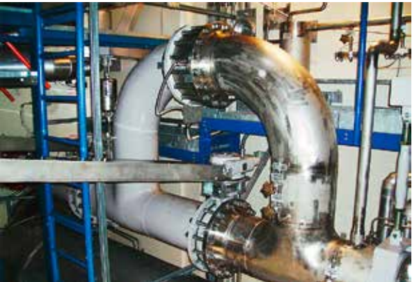
Zugehörige Leitungen mit Berstscheibe (Überdruck) und Armatur (Klappe), welche im Anforderungsfall vom Kommandoraum aus geöffnet werden könnte.
