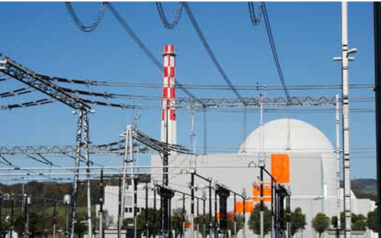
Über die Freiluftschaltanlage wird der KKL-Strom ins schweizerische Hochspannungsnetz eingespeist.
