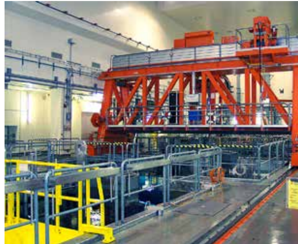
Brennelement-Handhabungsmaschine zum Platzieren/Umsetzen der Brennelemente.
