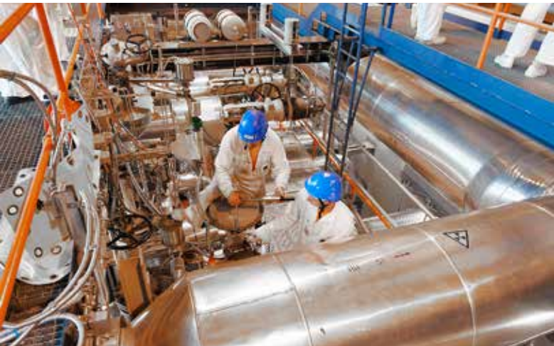
Dank konstanter Wartungs- und Erneuerungsarbeiten während der Jahreshauptrevision ist das KKL eine moderne Anlage.
