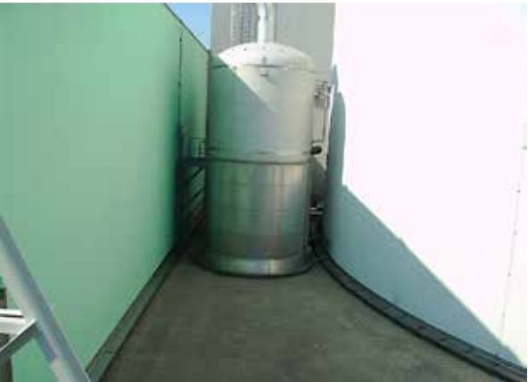
Filterbehälter an der Aussenwand des Reaktorgebäudes, durch welchen die gefilterte Containmentluft zum Abluftkamin geleitet wird.
