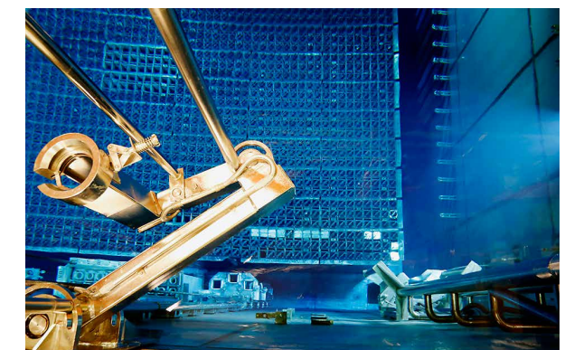
Blick ins Brennelementlagerbecken.
