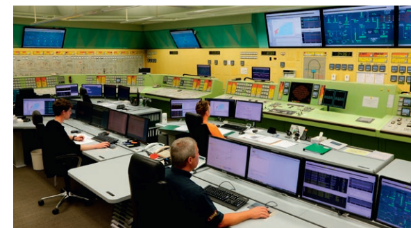
Im Kommandoraum überwachen Mitarbeitende die Anlage rund um die Uhr.
