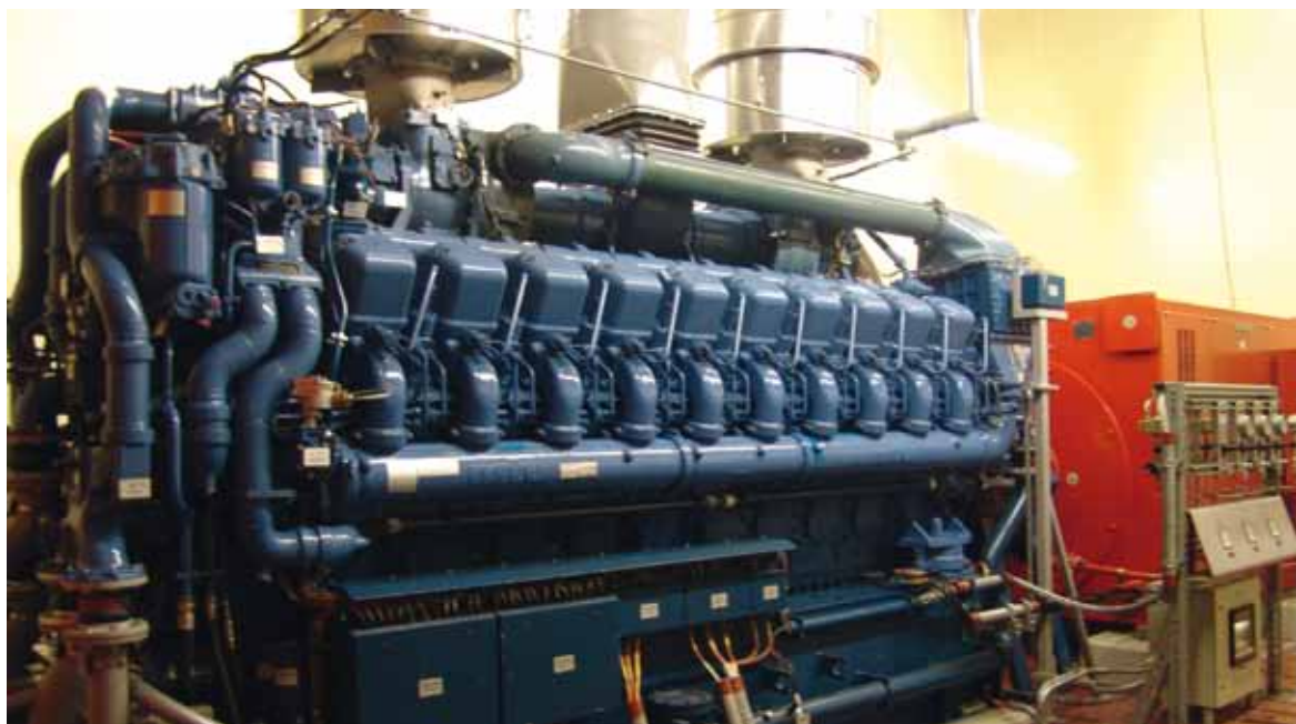
Der 20-Zylinder-Motor eines Notstrom-Dieselmotors.
