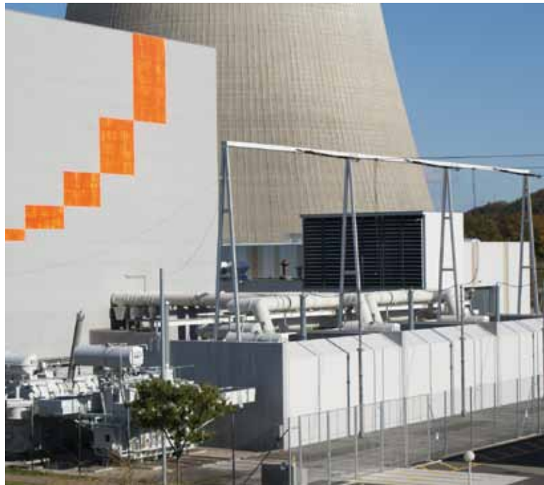
Drei Transformatoren bilden den Blocktransformator, ein vierter steht links als Reserve bereit.
